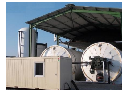
Méthanisation en voie sèche continue (OGIN/INEVAL)
